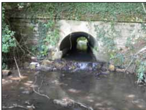
Pont de Chaume sur le Lambon devant faire l'objet d'une reprise d'aménagement
